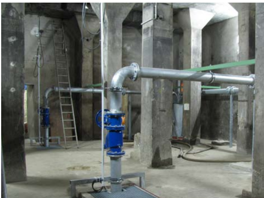
Pumpwerk im Regenrückhalte- und Absetzbecken Süd
