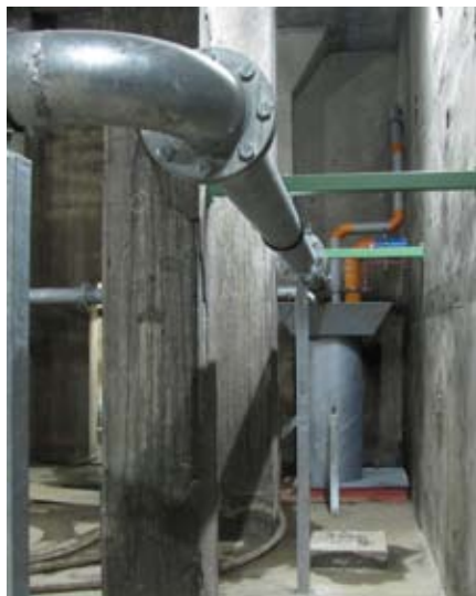
Einleitungstrichter in den Marbach mit den parallel geschalteten Drosselleitungen
